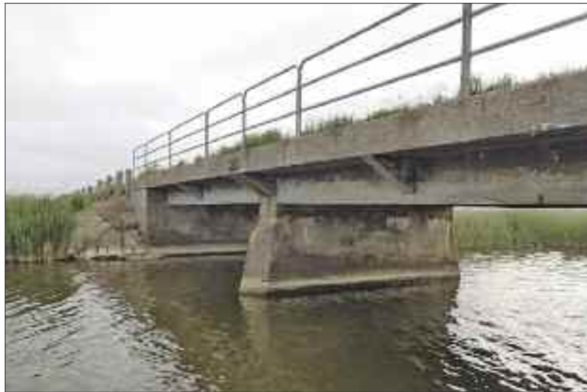
Eksempel på udlagt hotspot (hotsp-18). Dette hotspot omfatter alt beton på broen samt 40-50 betonpiller langs Lodbjergvej. Broen er bygget i 1931, og laverne har således haft 85 år til at indfinde sig.
